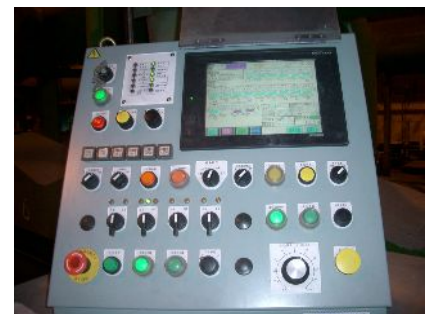
監視室操作盤 (機械設置とほぼ同等)
